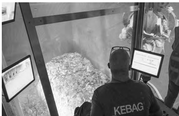
Der Blick des Kranführers in die Verbrennungsgrube der Kebag
